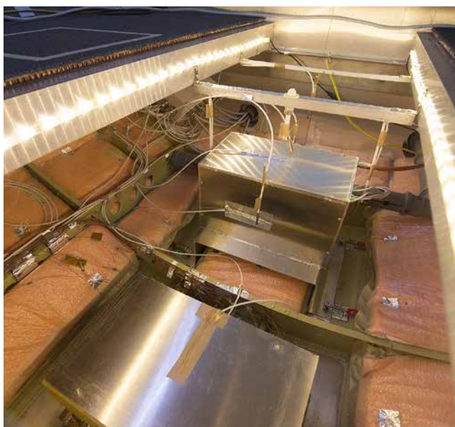
Der Unterbodenbereich des Kabinendemonstrators bietet vielfältige Möglichkeiten thermische Untersuchungen mit Hilfe so genannter Equipmentsimulatoren durchzuführen.
